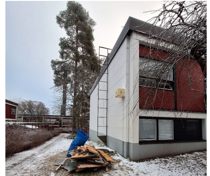
Kuva 25. Säilynyt alkuperäinen Lundstenin ja Kahrin suunnittelema tikastyyppi. Tikas on arkkitehtonisena detaljina kaunis ja harkittu, mutta ei täytä nykyisiä turvallisuusvaatimuksia. Alkuperäiset tikkaat tulee säilyttää, mutta niiden alaosaan on lisättävä aiheettoman kiipeämisen estävä lukittava kiipeilyeste. Kuva maastokäynniltä 5.12.2024 Kirsikka Siik / Ramboll
